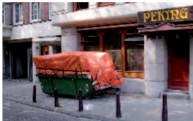
Bij aantreffen asbest in container kan u dat 3000 euro kosten: afvoeren naar vergund verwijderingsbedrijf, inventarisatierapport en vrijgaveverklaring.
